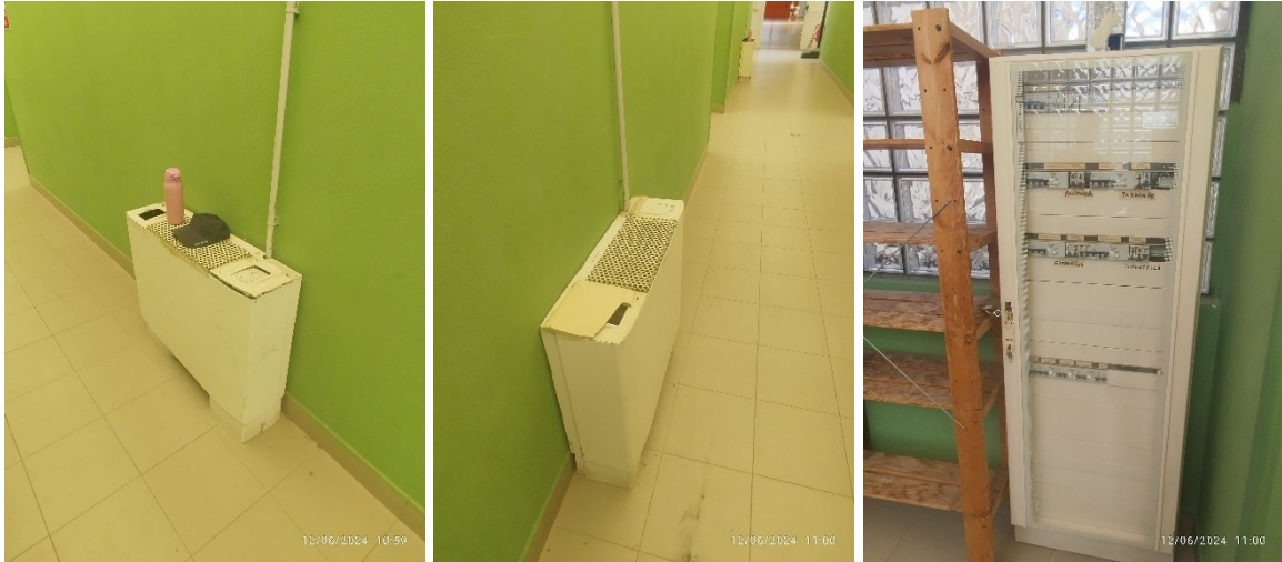
Zona corridoio fancoil danneggiati e sportello quadro elettrico chiuso con lucchetto
