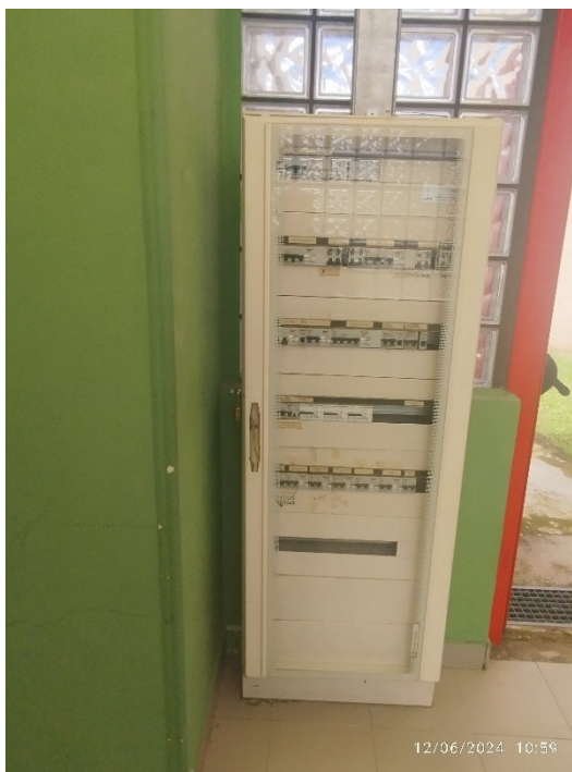
sportello quadro elettrico chiuso con lucchetto
