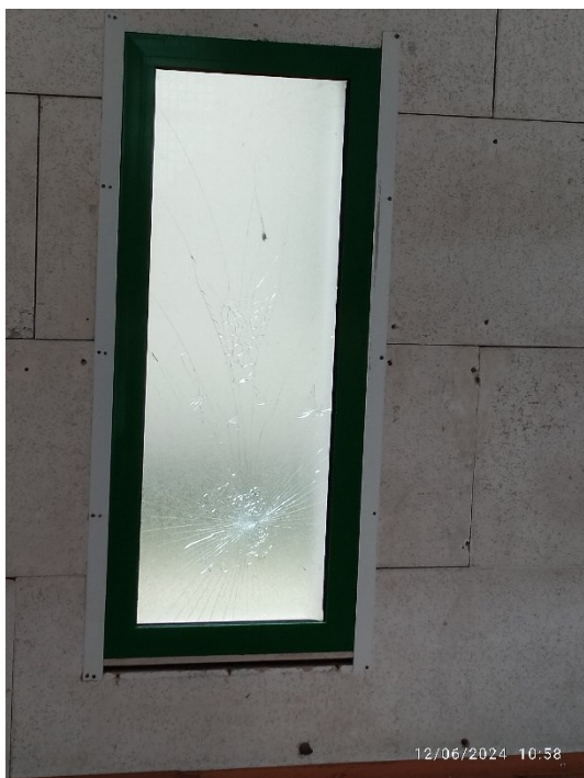
presenza di vetri rotti
