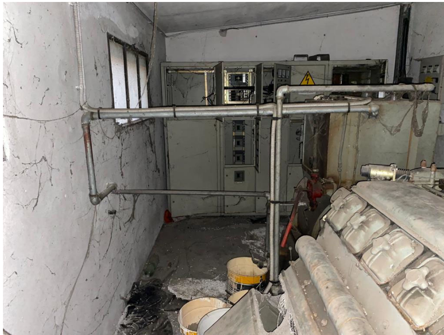
Figura 9 –Locale di alloggio generatore ex ospedale psichiatrico
