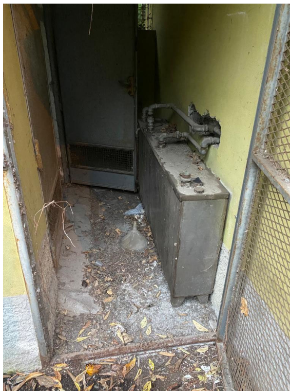
Figura 10 – Cisterna secondaria di alimentazione del generatore
