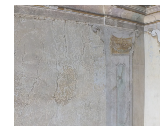
Efflorescenza salina e concrezioni di carbonato di calcio
