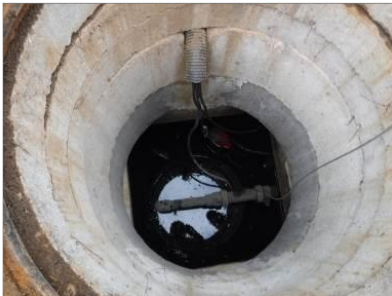
Figura 6 – Vasca di prima pioggia ubicata in via Vespucci
