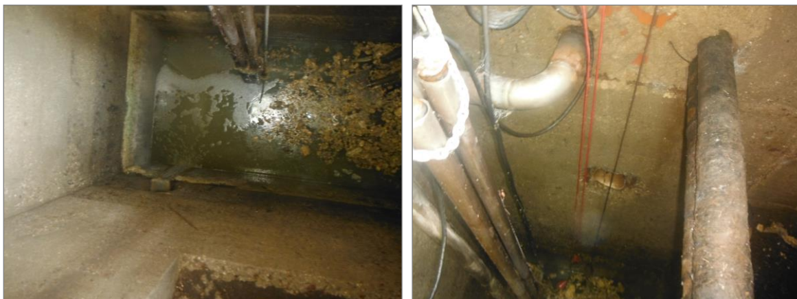
Figura 17 – Stazione di sollevamento al nodo 2504
